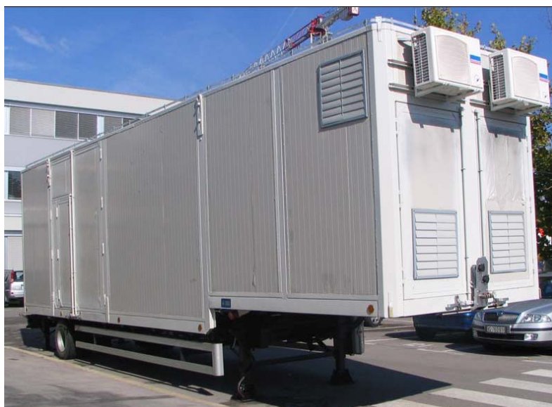
Slika 1 – Spoljašnji izgled kontejnerske transformatorske stanice
